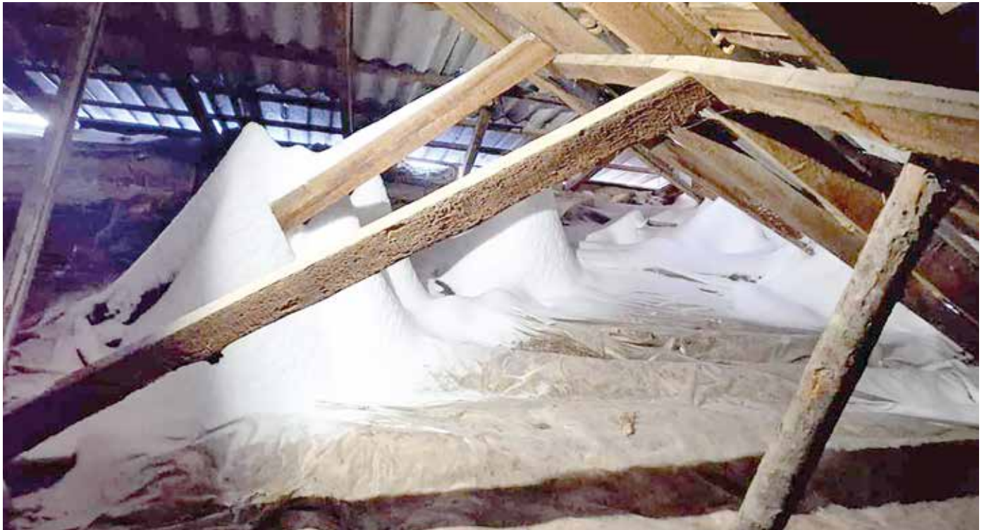
■ Bild des reparaturbedürftigen Daches im Kindergarten Puhoi.
