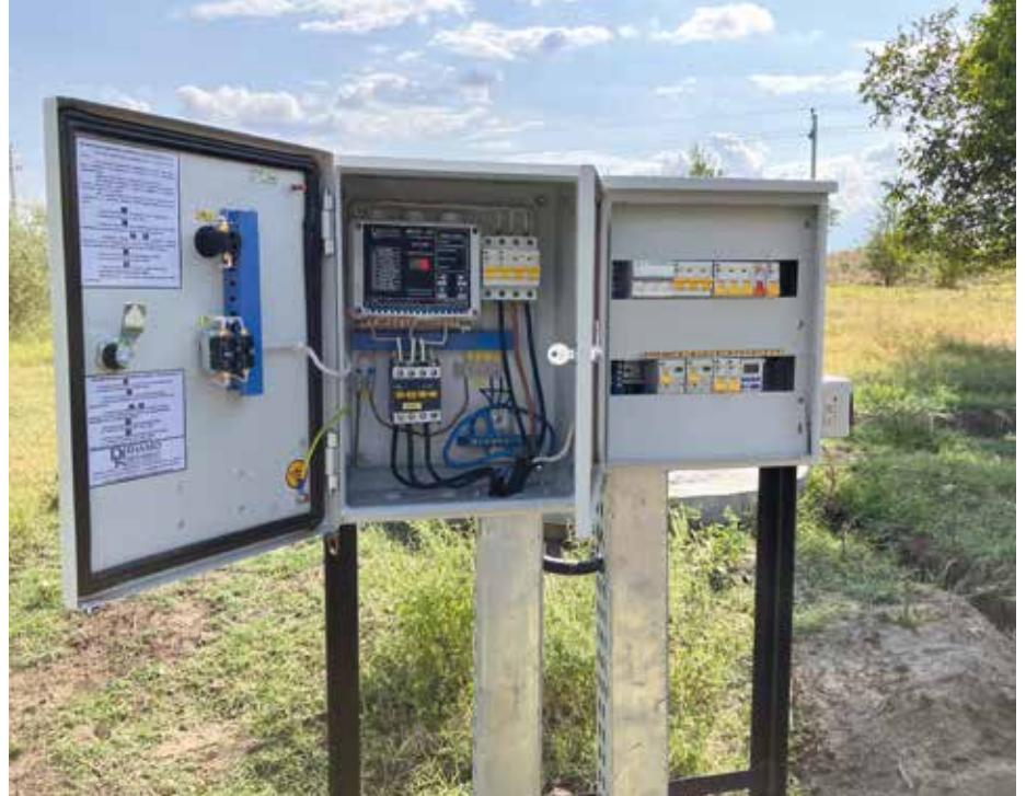
■ Die Schaltanlage der Pumpenstation in Purcari. Sie muss noch in ein kleines Häuschen integriert werden.
