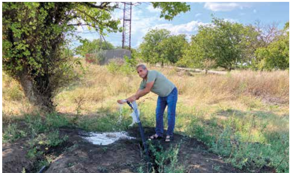
■ Der leitende Ingenieur der Firma Electromontaj in Purcari, demonstriert dass das Wasser durch die Pumpenstation mit hohem Druck gefördert wird. Bilder: Pro Humanitate
