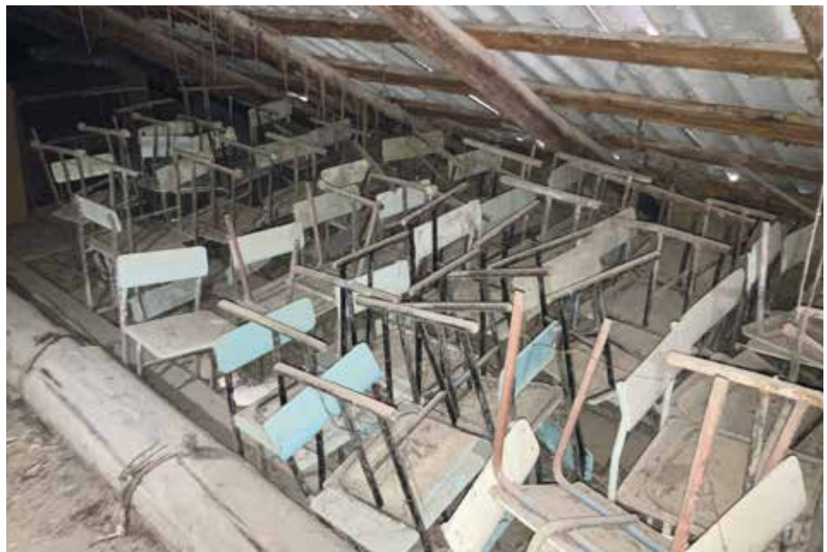
■ Altes Schulmaterial aus Sowjetzeiten steht unter einem löchrigen Eternitdach.
